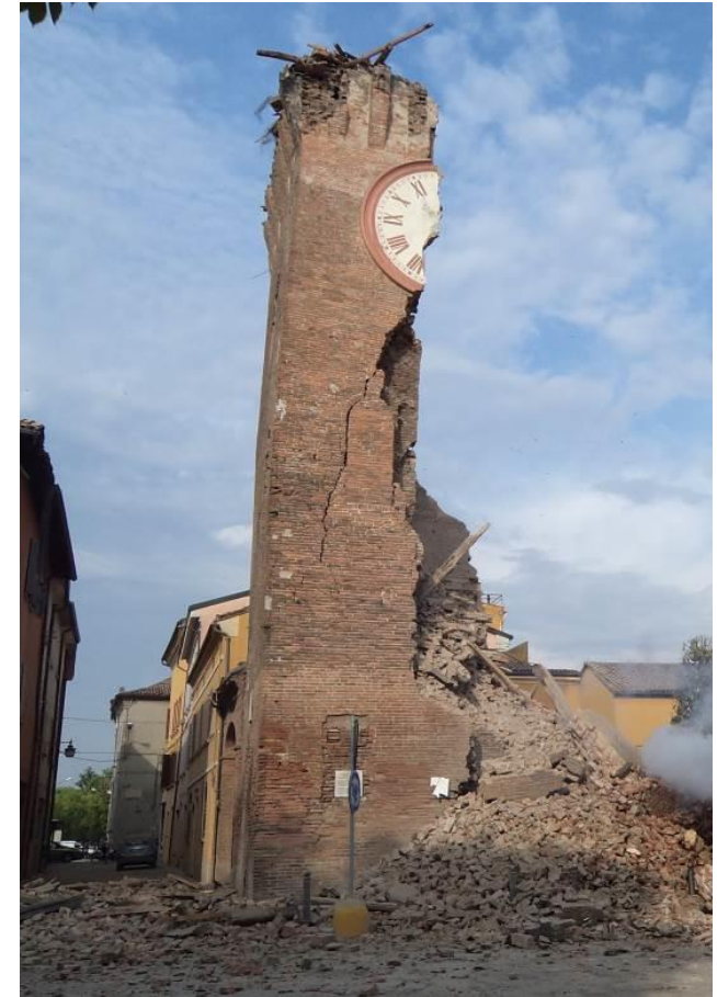
Fonte: Torre dell'Orologio Comune di Finale Emilia (MO) – Danni alla Torre Campanaria
